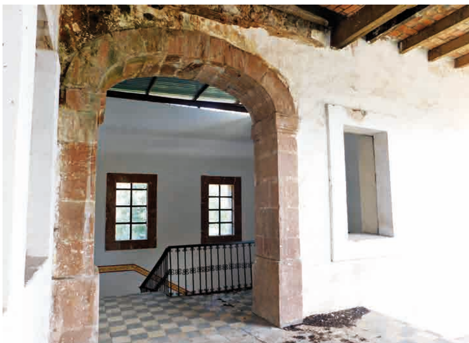
En algunas zonas el techo está muy dañado.
